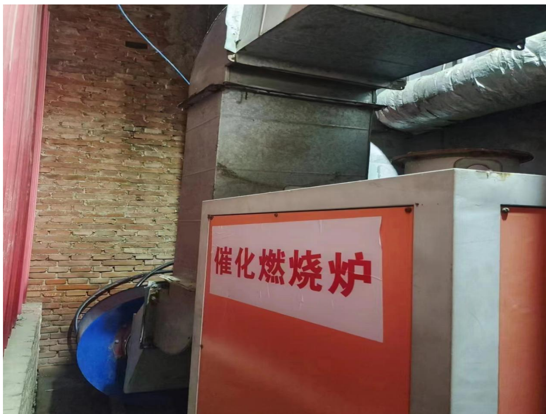
催化燃烧设施
