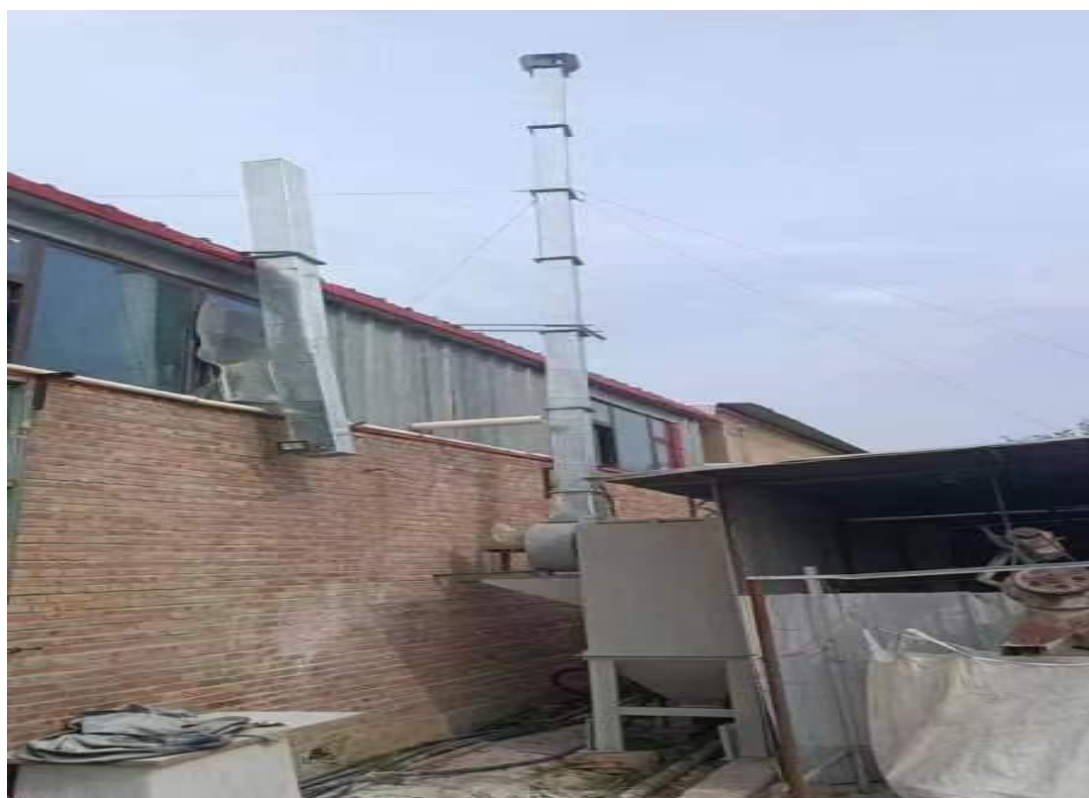
破碎工序布袋除尘以及排气筒
