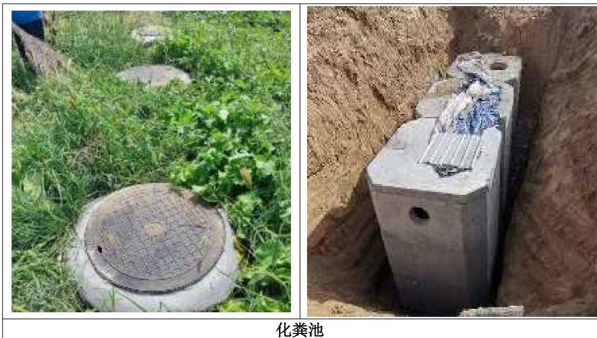
图 3-2 项目废水污染物处理措施现场照片
