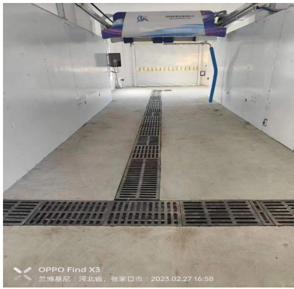
图 3-5 地下循环沉淀池
