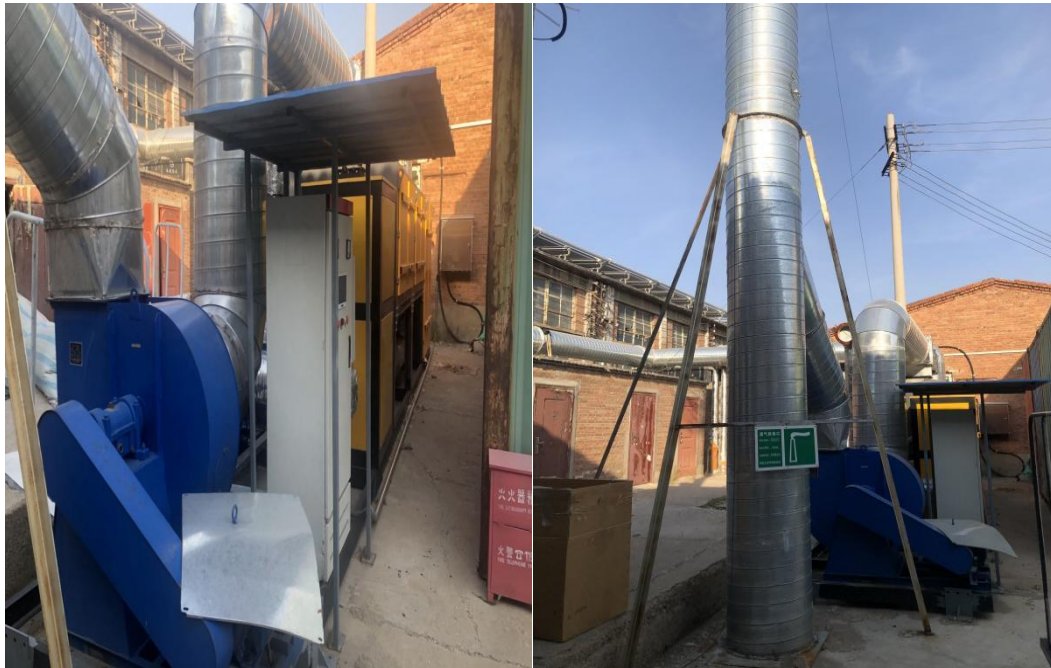
过滤+吸附+蓄热式催化燃烧+DA002 排气筒
